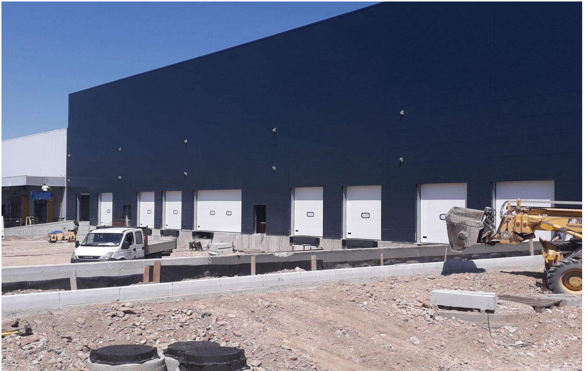
SEZIONALI IN BATTERIA +BAIE DI CARICO
